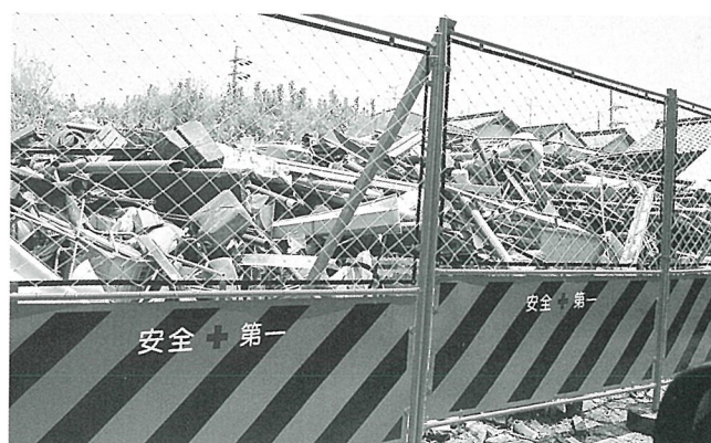
住宅街の一角に建設廃棄物が保管? 放置?
