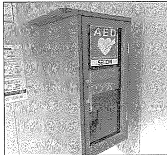
工場内に設置された AED
