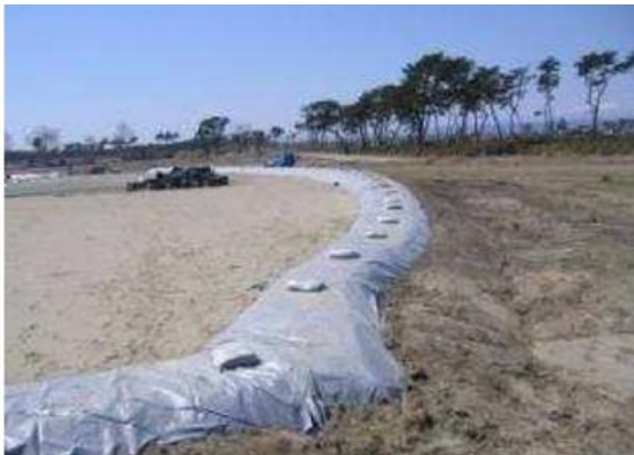
環境対策(遮水シート)
